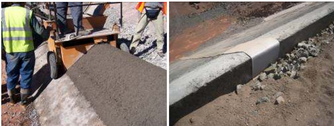
Figs. 5 and 6 Construction of curbs and embedding of PVC anchor wing Construction des bordures extrudées et placement des ailes d'ancrage PVC
