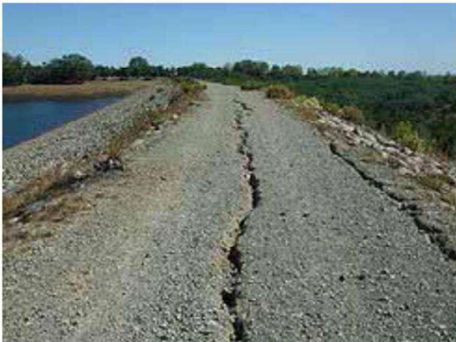
Fessure del coronamento (da Bray et al., 2010).
