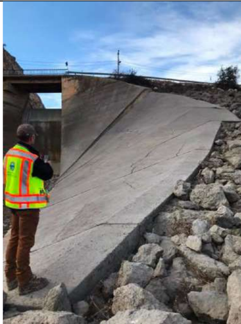
Lesioni ai muri di scarico
