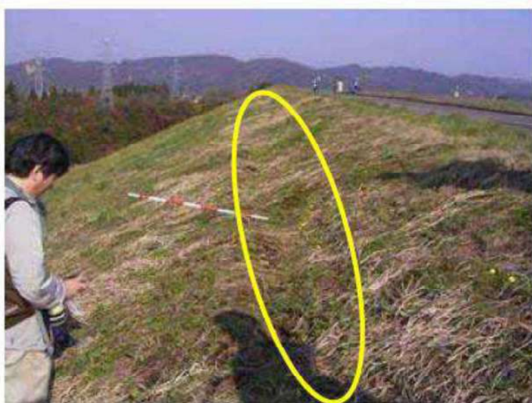
Cedimenti e fessure osservati nella sponda esterna
