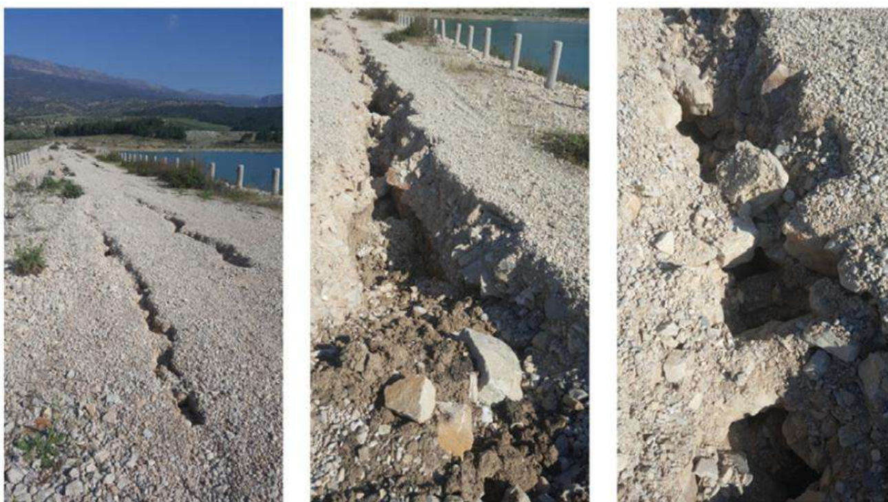
Fessure longitudinale rilevate a seguito del sisma del 06/02/2023
