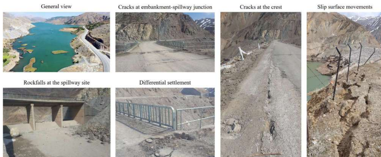
Immagini varie dell'opera e dei danni riscontrati
