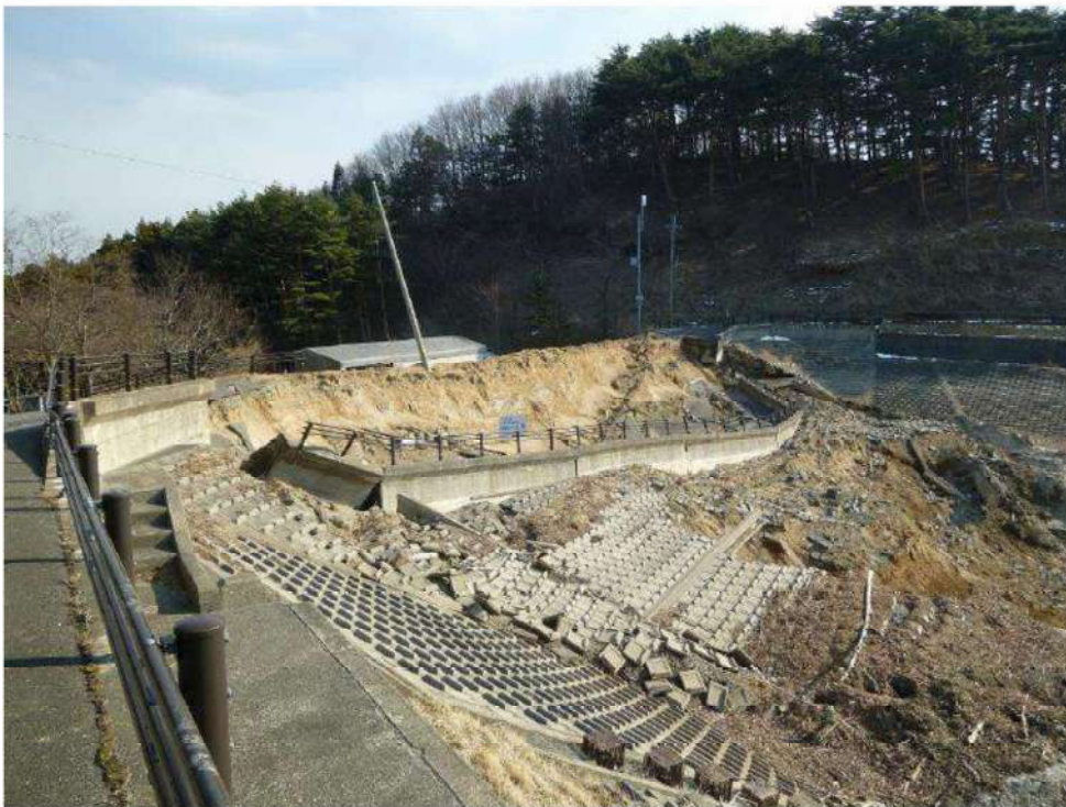
Fotografia dopo il collasso della diga di sella secondaria
