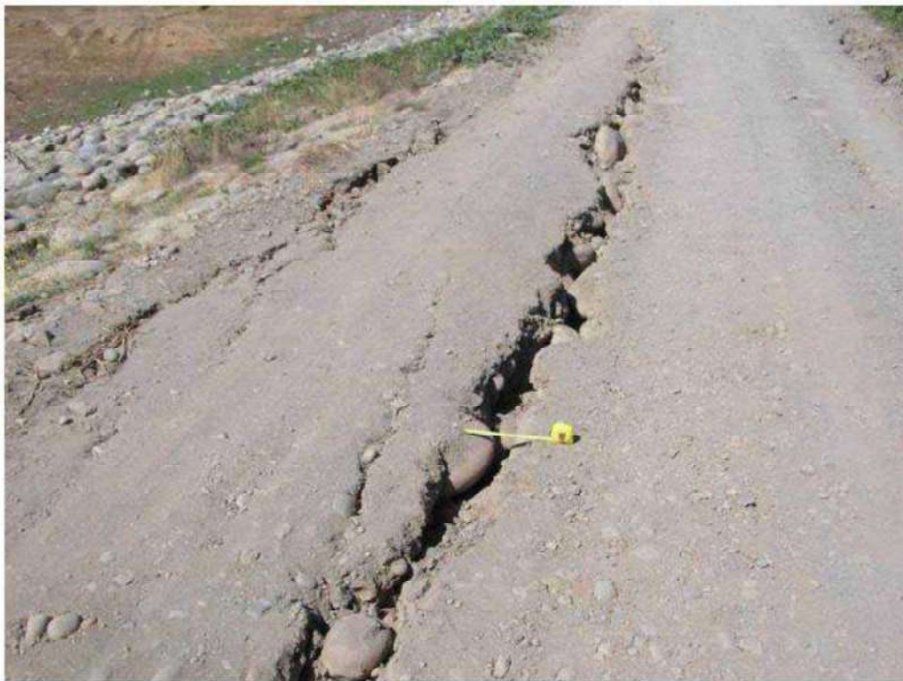
Fessura sul coronamento della diga a sella (da Bray et al., 2010).
