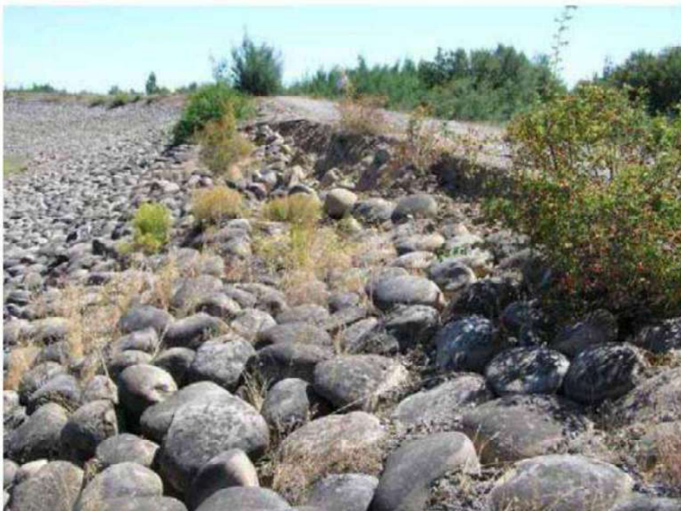
Cedimento C – vista dal lato destro dell'argine (da Bray et al., 2010).
