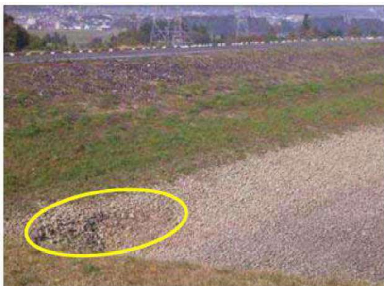
Cedimenti superficiali osservati sponda lato bacino
