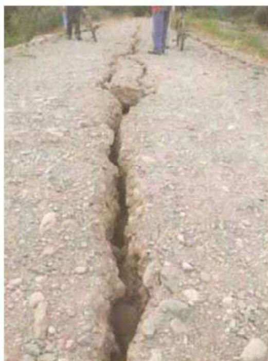
Fessurazione del coronamento vicino alla sponda destra dell'arginatura (da Bray et al., 2010).
