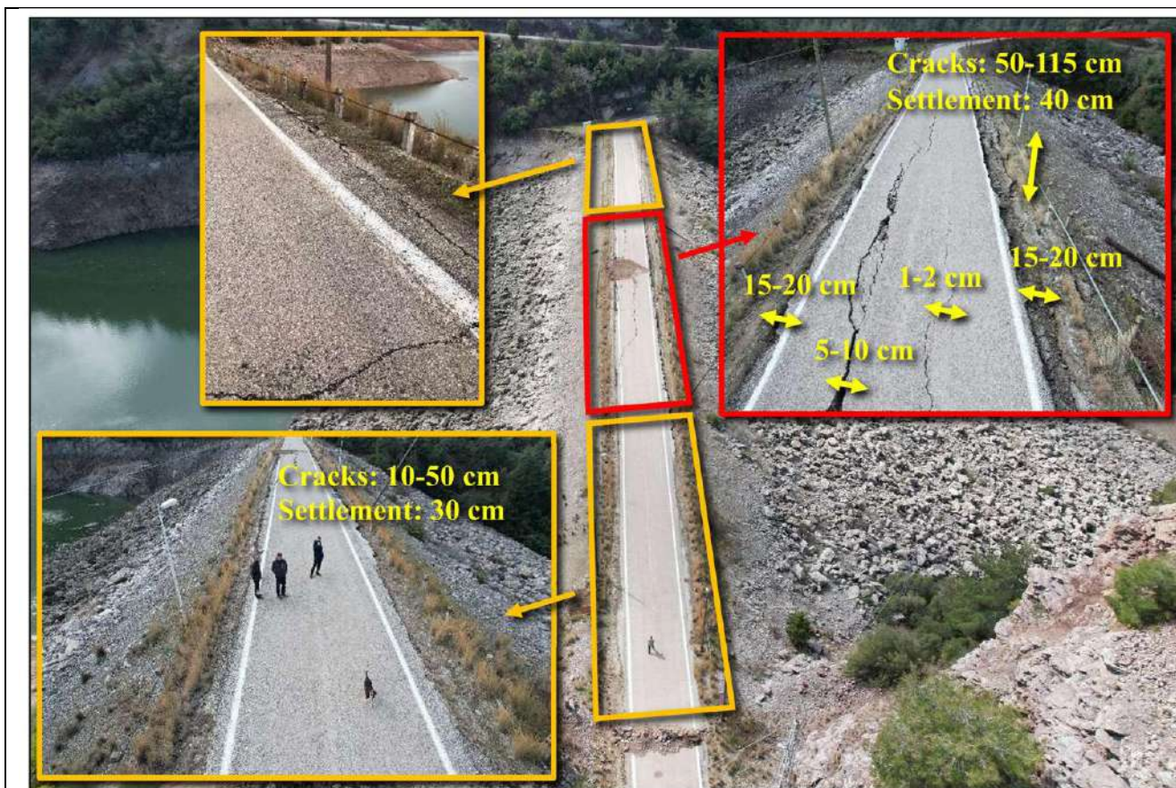
Principali danni riscontrati
