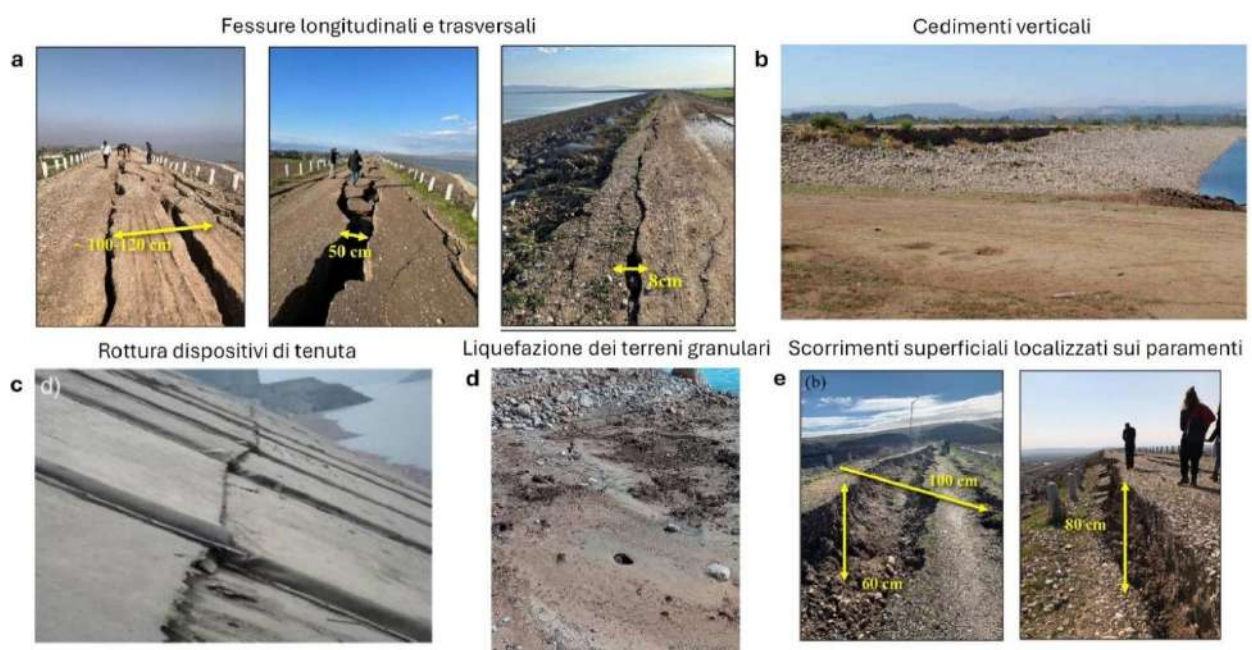
Figura 1 - Esempi di danni osservati in sito su dighe in materiali sciolti interessate da terremoti: a) fessure in cresta alla diga di Reyhanli [21]; b) cedimenti verticali della diga di Coihueco [4]; c) rottura del rivestimento del paramento di monte della diga di Zipingpu [22]; d) liquefazione terreni di fondazione della diga di Sultansuyu [23]; e) scorrimenti superficiali sui paramenti delle dighe di Sultansuyu e Reyhanli [21].
