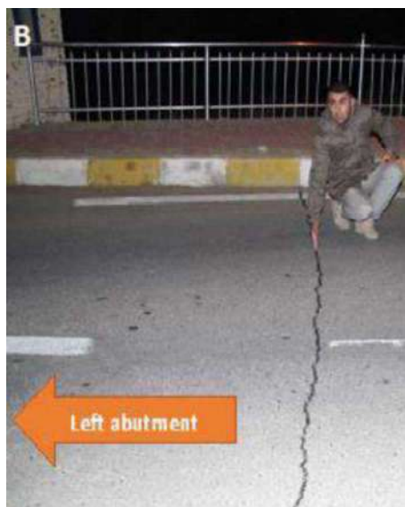
Una fessura trasversale
