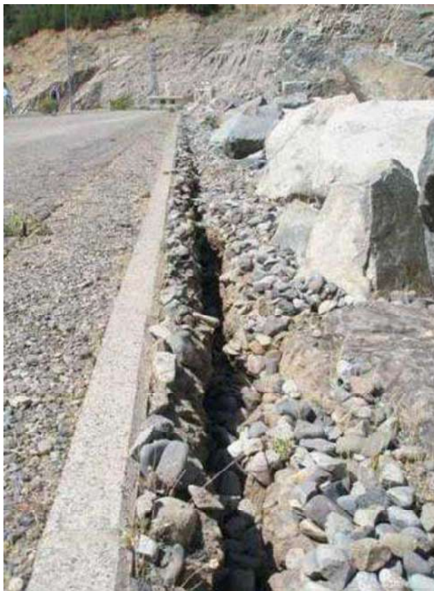
Fessurazione longitudinale in cresta nel lato del paramento di monte (Noguera, 2010)
