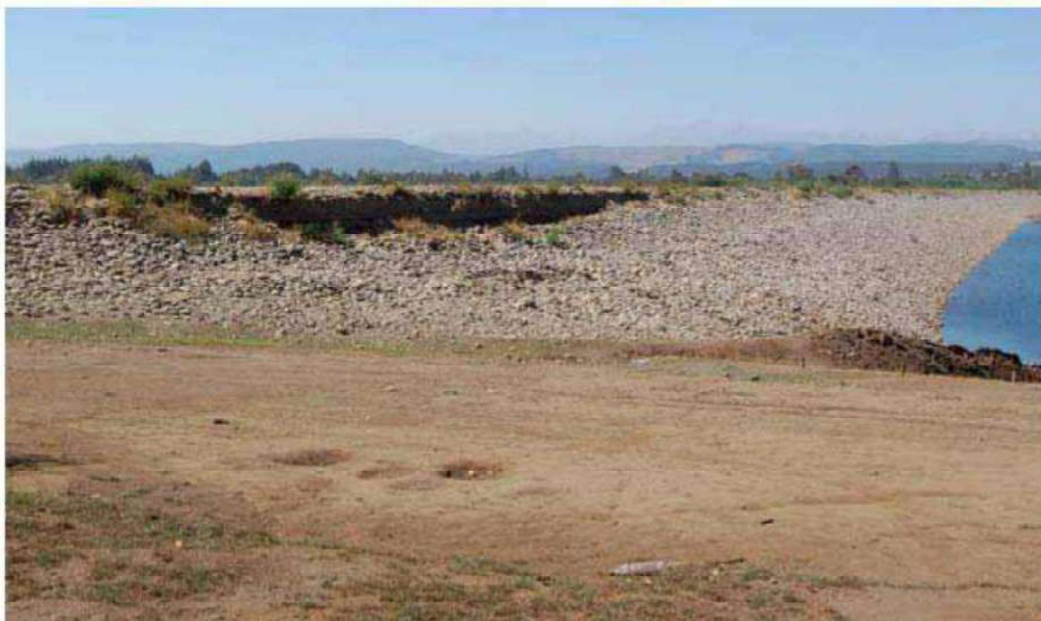
Cedimento A – vicino alla scarpata della spalla sinistra sul coronamento della diga e rigonfiamento in basso a destra nella foto (da Bray et al., 2010).
