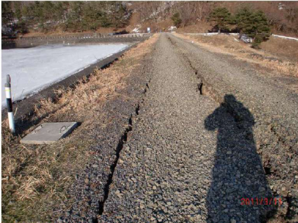
Fotografia della diga post terremoto
