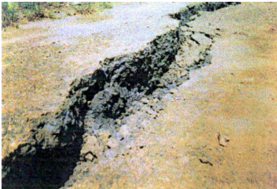
Fessura causata dall'evento sismico
