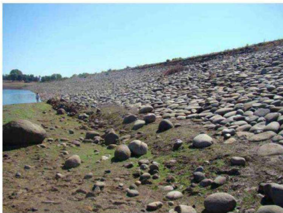
Cedimento B – Situato a destra della parte più alta dell'argine (da Bray et al., 2010).
