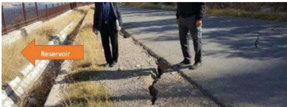
Nicchia di distacco ubicata sulla spalla sinistra.
