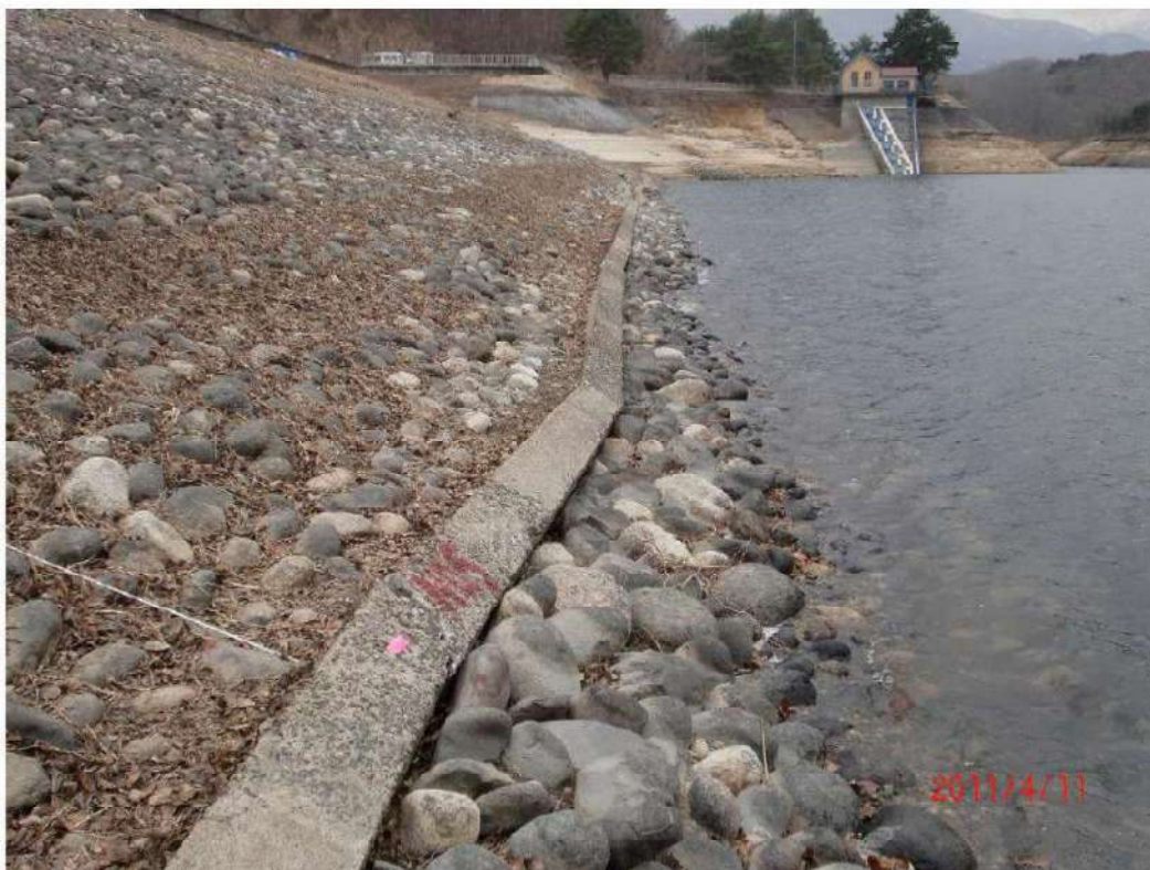
Fotografia della diga post terremoto
