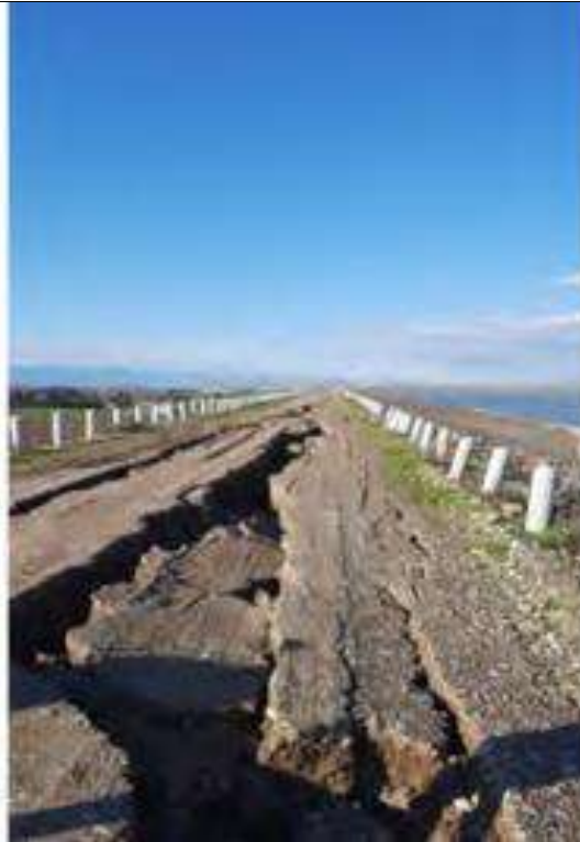
Fessure longitudinali in cresta
