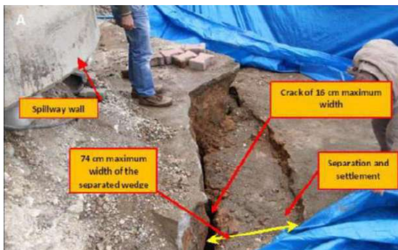
Fessura in corrispondenza dello sfioratore laterale.
