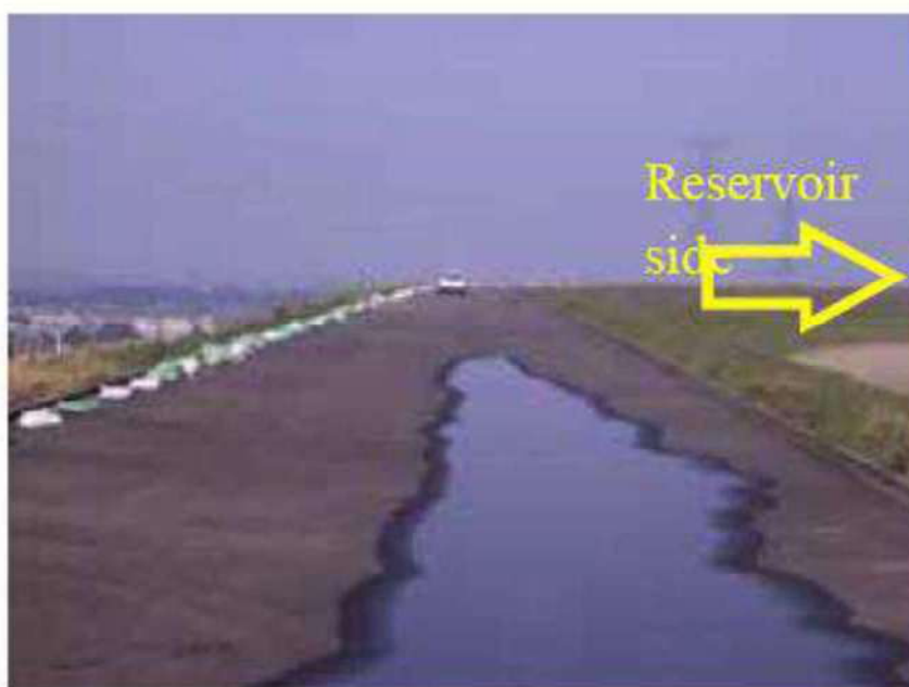
Inclinazione della pavimentazione sul coronamento
